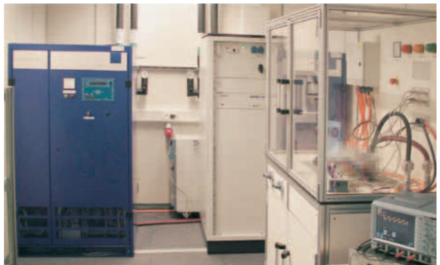
❶ Betrieb eines Inverters auf dem Testsystem von SET
