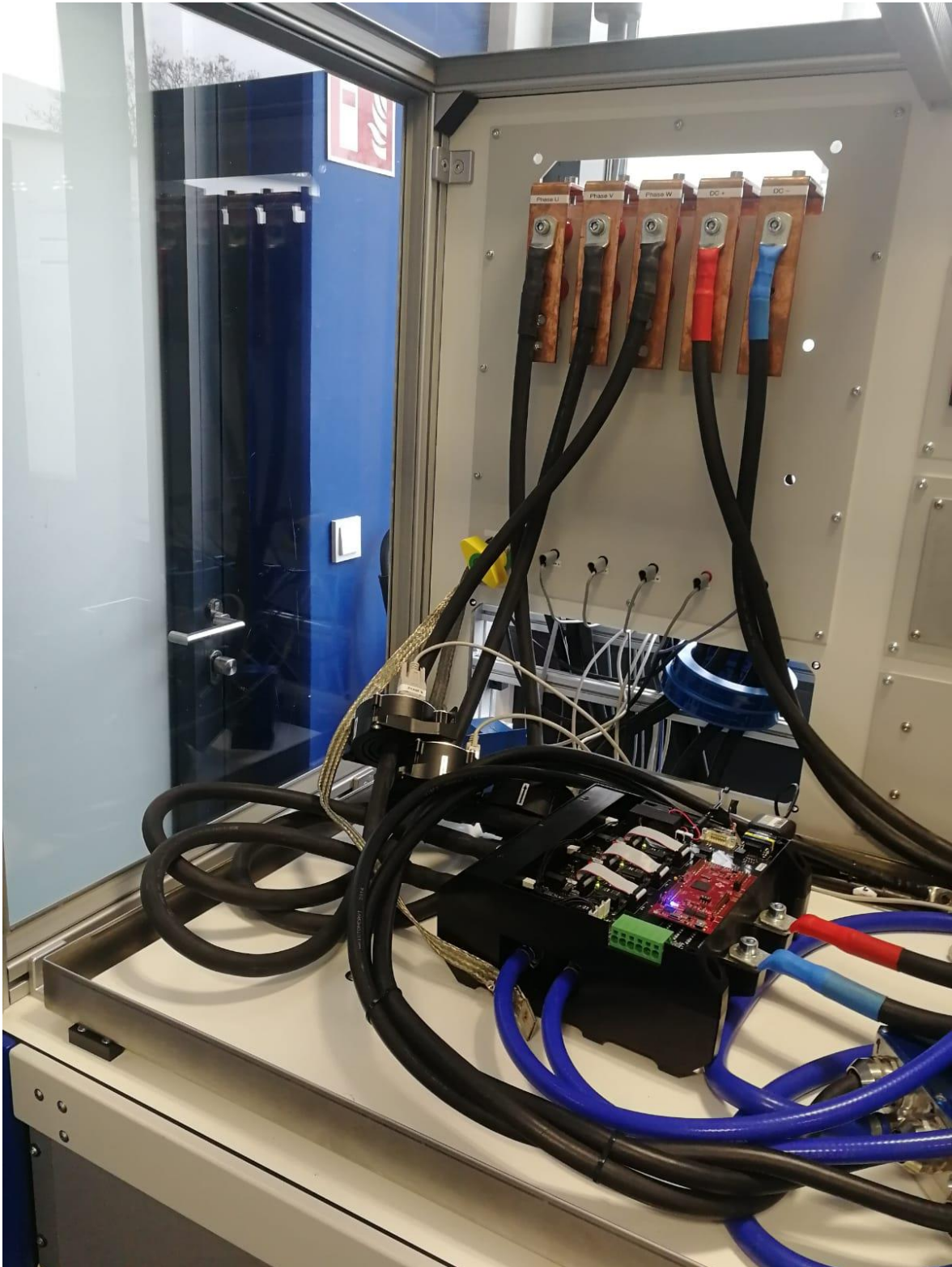
Abbildung 39: Wolfspeed Cree Inverter im P-HIL Prüfstand (EME)
